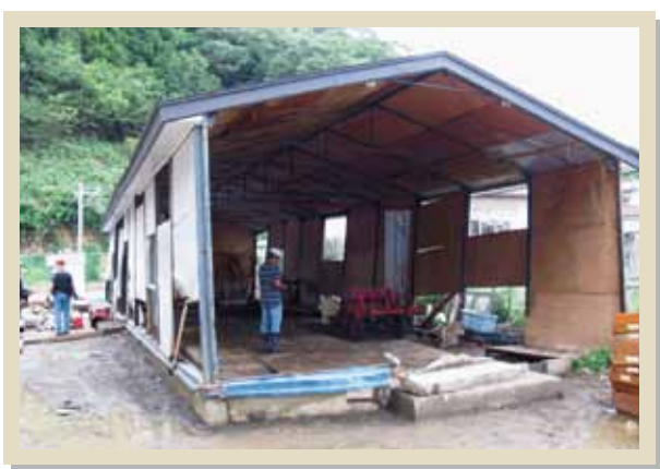
東日本大震災で被害を受けた文化財の保全活動。被災資料を移動した後の収蔵施設。宮城県石巻市、2011年6月。
